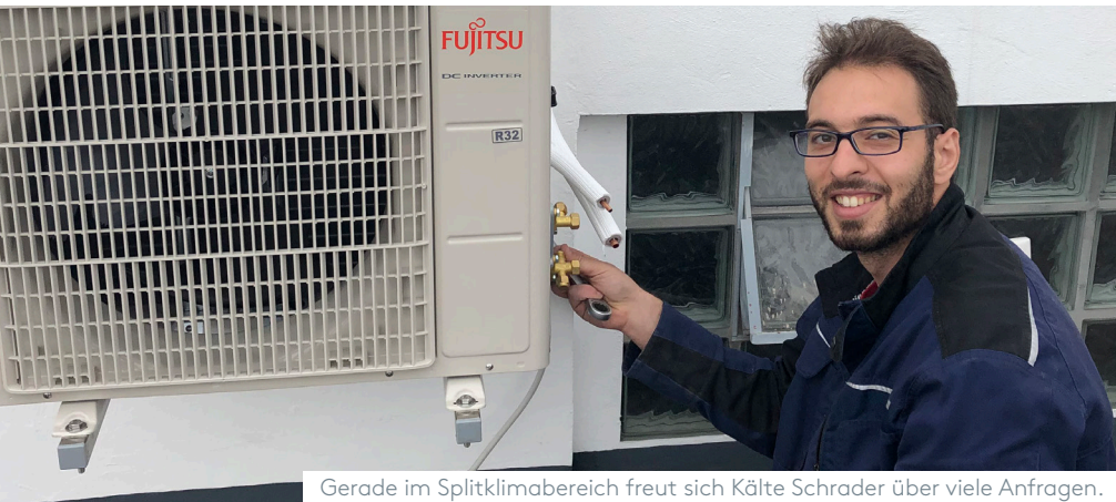
Gerade im Splitklimabereich freut sich Kälte Schrader über viele Anfragen.
